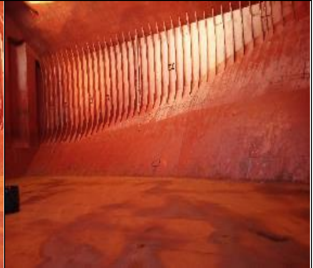
10. Banda de estribor en condiciones de encalar.
