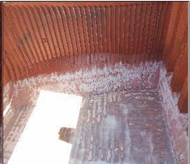
14. Banda de estribor recubierta con película de cal.
