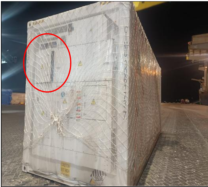
45. BESS CIMU 206173-7, puerta abierta.
