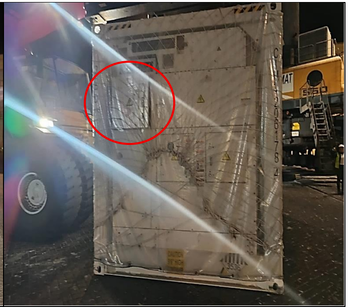
46. BESS CIMU 206178-4, puerta abierta.
