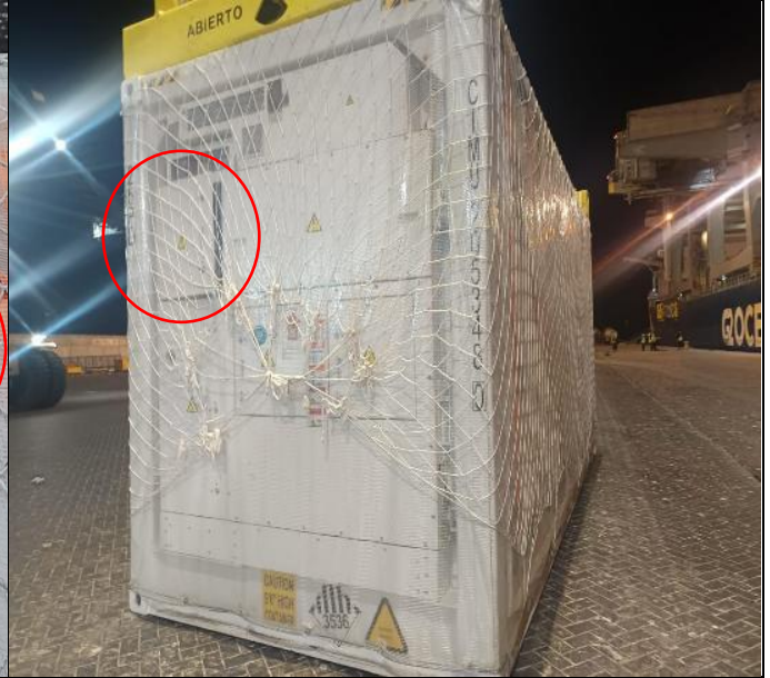
44. BESS CIMU 205348-0, puerta abierta.
