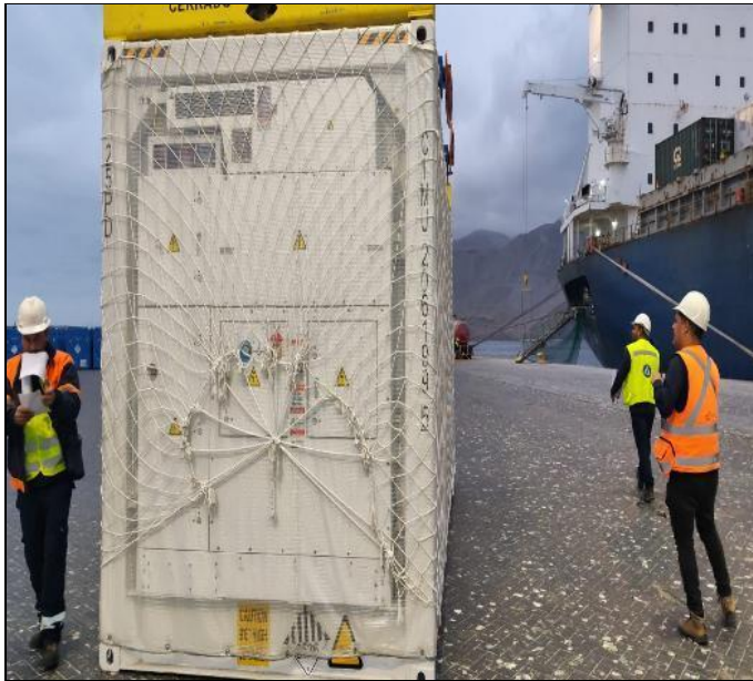
9. Batería descargada en el delantal del muelle.
