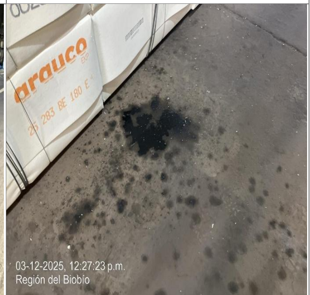
10.- Vista de manchas de aceites frescas en zona de acopio.
