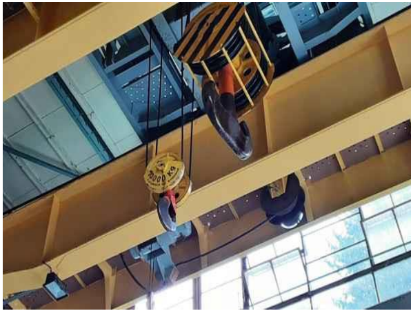
5.- Polipasto principal y auxiliar del puente grúa.
