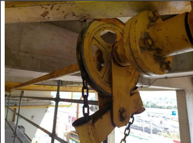
5.- Sistema de traslación viga principal.
