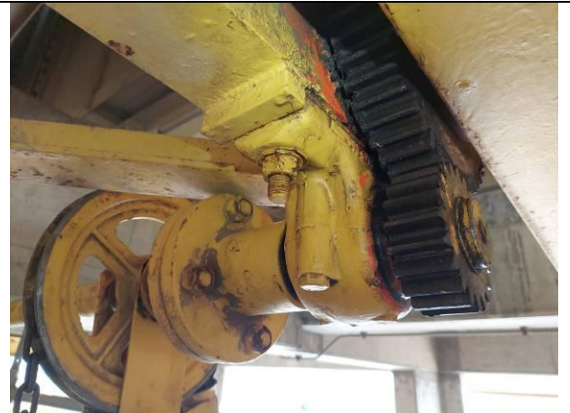
6.- Sistema de traslación viga principal.
