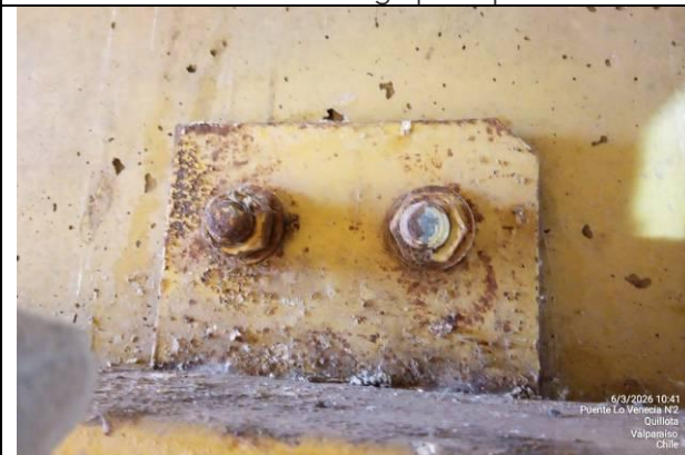
7.- Soportes de fijación viga carrilera derecha.
