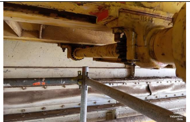
2.- Sistema de traslación viga principal.
