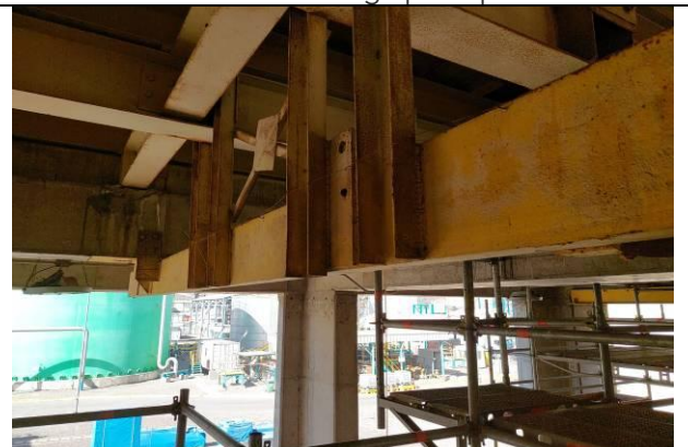
8.- Soportes fijación viga carrilera izquierda.
