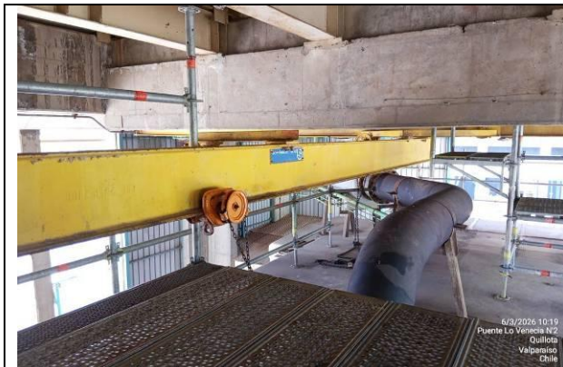
1.- Puente grúa manual 3 ton.
