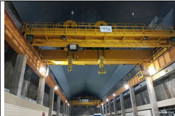
1.- Puente grúa n° 2
