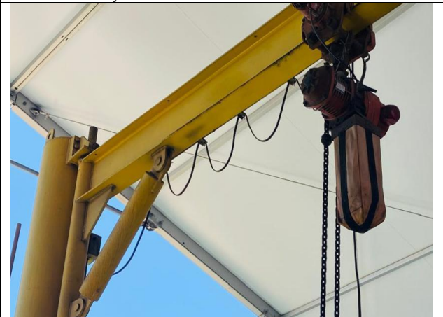
4.- Cable festoon en buen estado.
