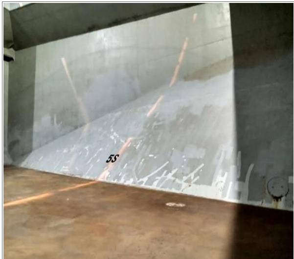
18. Banda de estribor en condiciones de encalar.
