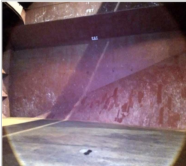
14. Banda de estribor en condiciones de encalar.
