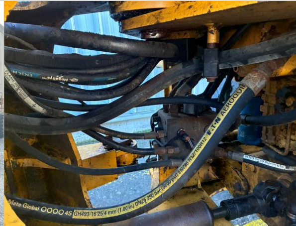
32. Mangueras hidraulicas en orden.
