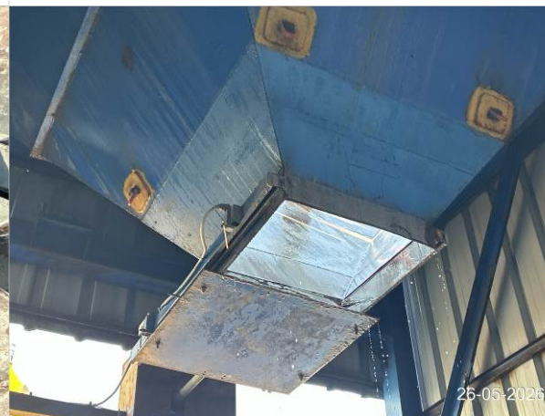
12. Escotilla del buzón de transferencia sin exceso de grasa.
