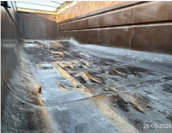
29. Tolva de camiones en buenas condiciones.
