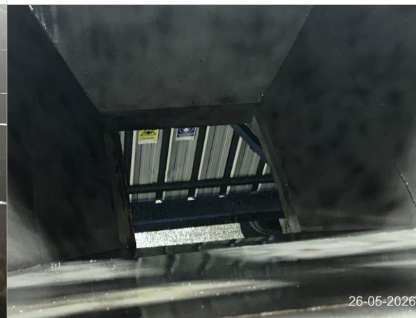
8. Escotilla del buzón de transferencia sin exceso de grasa.
