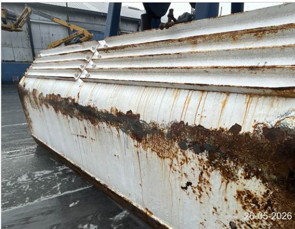
23. Exterior sin cascarras de óxido suelto.
