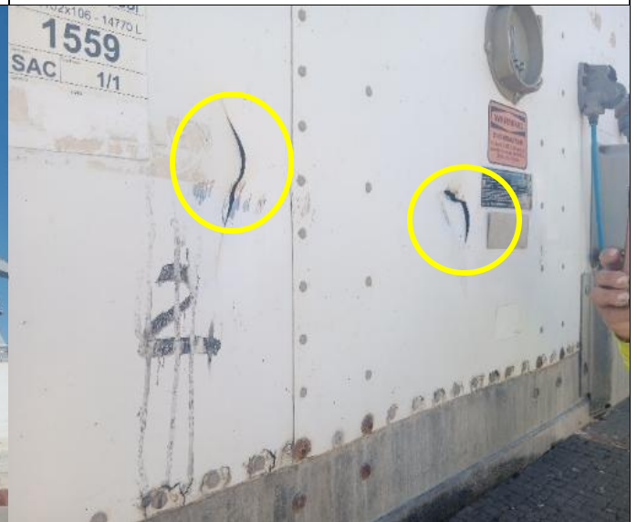
76. Panel frontal roto en múltiples zonas.
