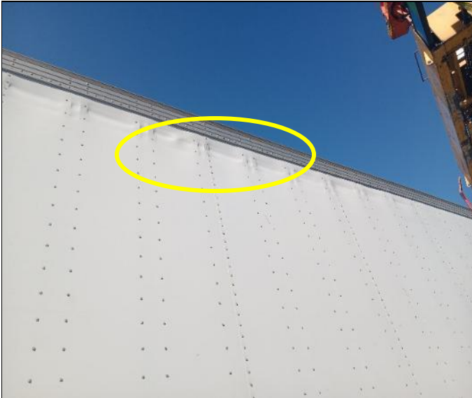
41. Abolladura en panel lateral izquierdo.
