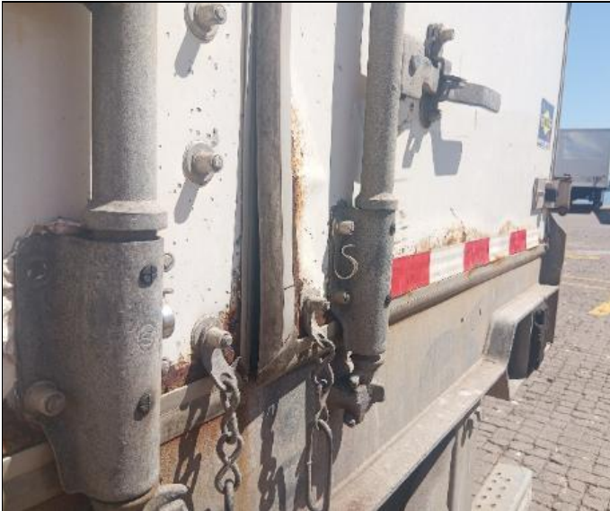
81. Puerta derecha abollada en la zona inferior y con presencia de oxidación
