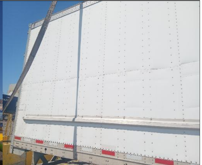
78. Panel lateral izquierdo con pintura rayada.
