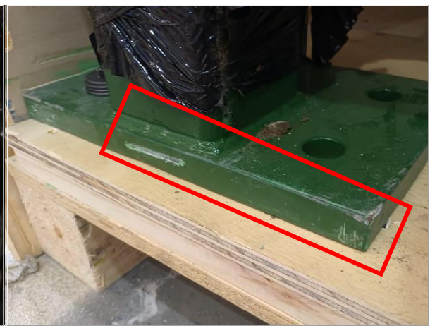
54. Vista de las raspaduras en la pintura.
