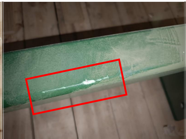
32. Vista de la raspadura en la pintura.
