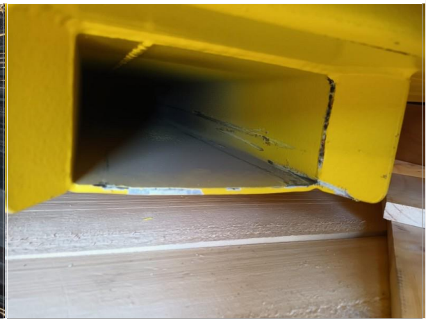
106. Vista de las raspaduras en la pintura.
