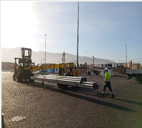
19. Proceso de cambio de maquinaria, para el traslado a sector de carguío.
