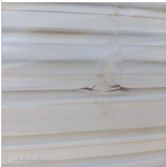
75.- Vista a daño de 2 piezas en lote 3623207059.
