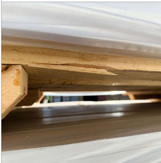
111.- Vista tabla basal quebrada en lote 3623220098.
