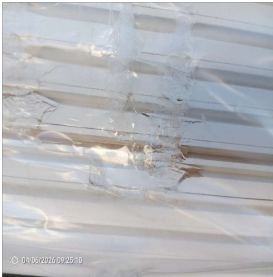
69.- Vista a daño de 6 piezas en lote 3623206964.
