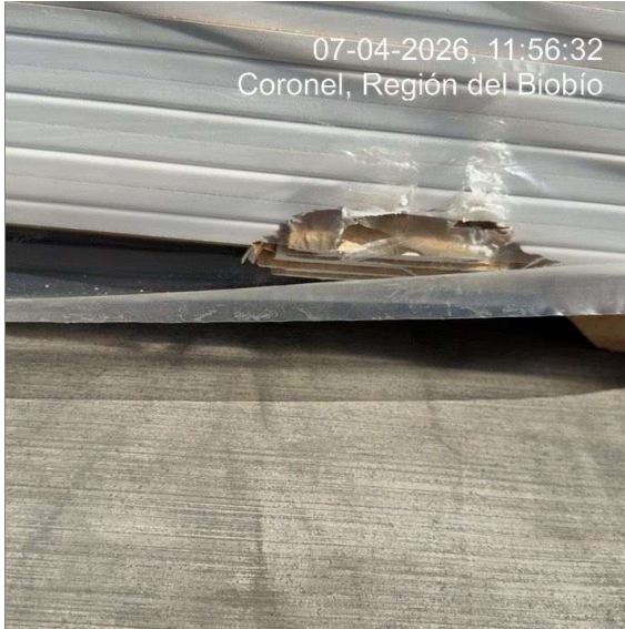
55.- Vista daño a 3 piezas de lote 3623221689.
