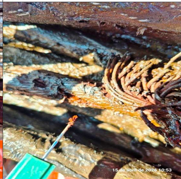
8. Otra vista de grasa con polvo abrasivo seco al interior del cable.
