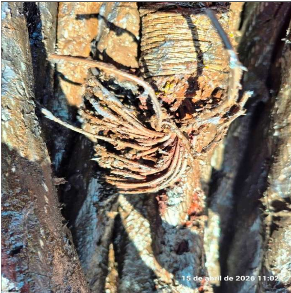
5. Otra vista de daño en cable con alambres cortados.
