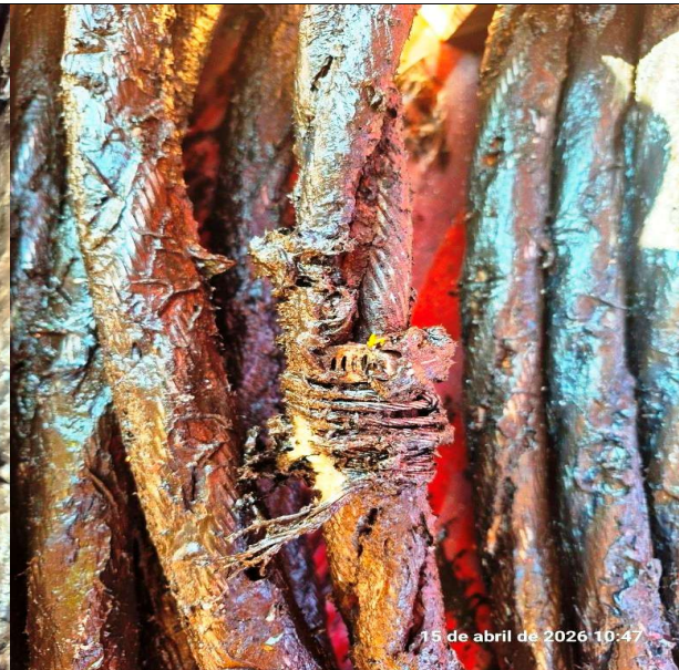
6. Vista de cable dañado en otro extremo del corte.
