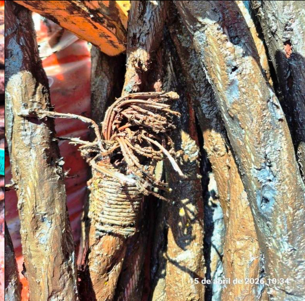
4. Vista del cable dañado en torón.
