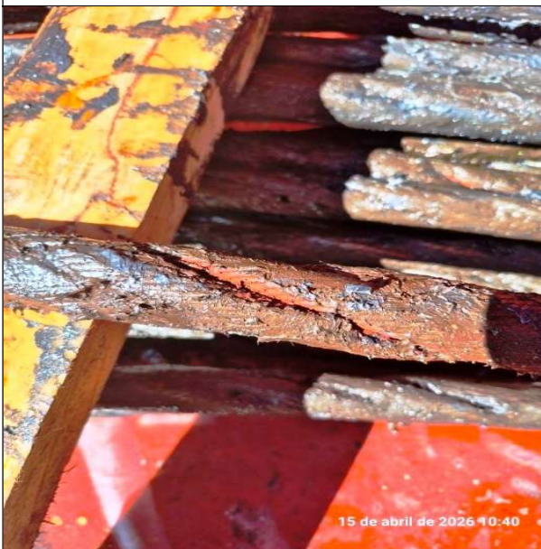
7. Vista cable interior torón faltante visiblemente con escasa lubricación
