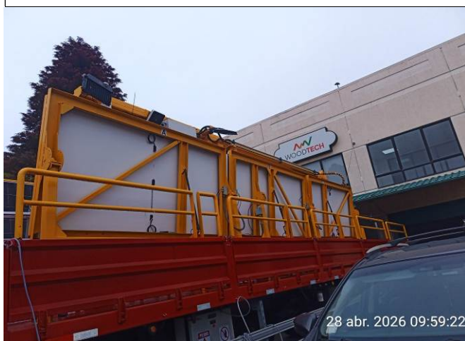
7.- Vista de baranda anticaídas sector paneles solares A-B y C en rampla soporte de Grúa.
