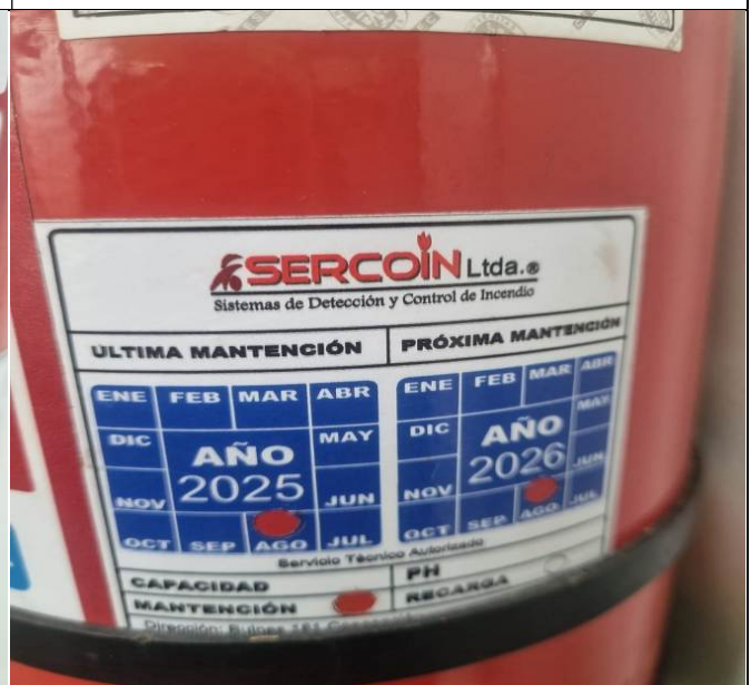
4.- Vista de fecha de vencimiento de utilidad del extintor en Grúa.
