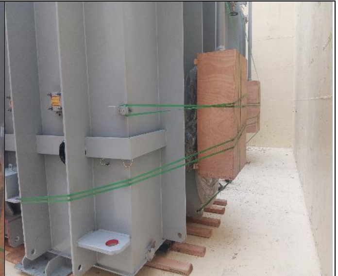
26. Otra vista del transformador sin daños aparentes.
