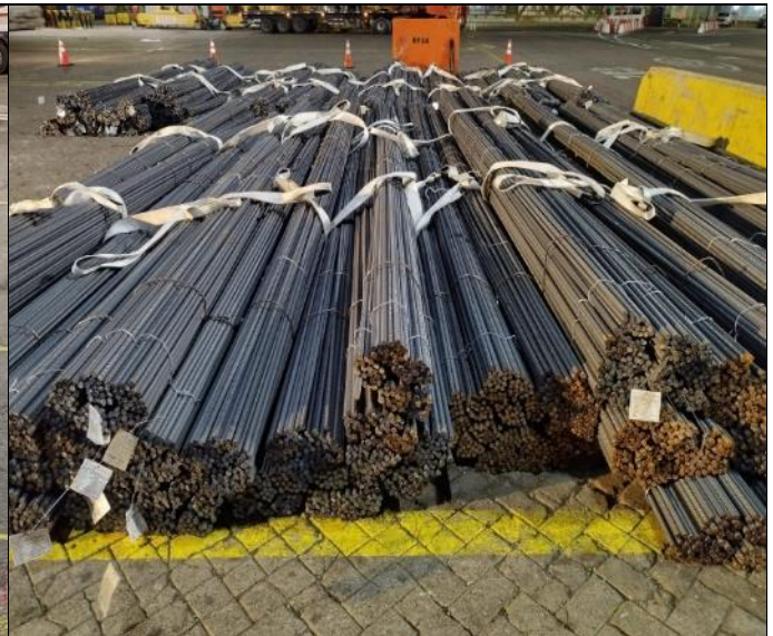
14. Vista lateral de la zona atados de alambrones de acero sector muelle sitio No. 8.
