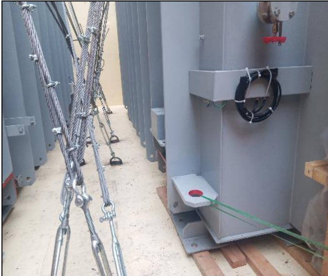
25. Transformadores trincados con alambres de acero , estibados sobre madera para evitar desplazamiento.
