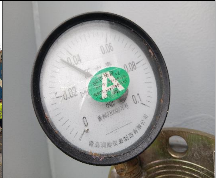
38. Vista de la manómetro del transformador con presión positiva.
